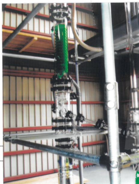
▲ 装置全体 (一部)
